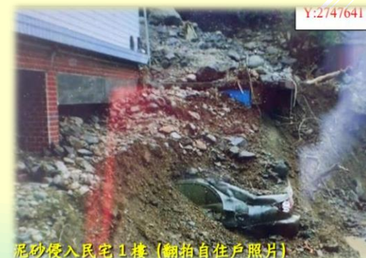
大量土石流沖毀民宅
